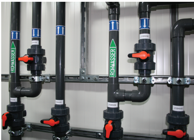
Abbildung 2: Kennzeichnungen von Betriebswasserleitungen (Quelle: MULTI-ReUse)
